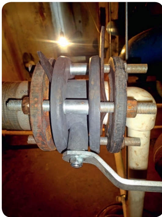
ПОДВАЛ ЖИЛОГО ДОМА (КОНТУР ГВС)
