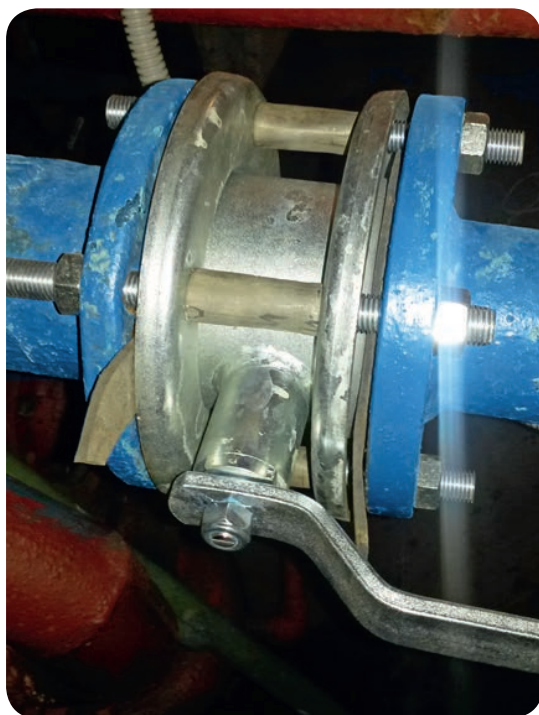
ПОДАЧА В ТЕПЛООБМЕННИК DN 80
