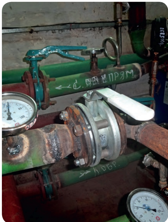
ТЕПЛОПУНКТ (ОБВЯЗКА ТЕПЛООБМЕННИКА)
